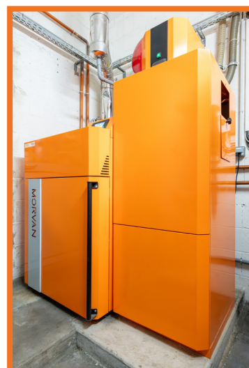
Nos 12 bureaux sont également chauffés par une chaudière GM EASY 36, garantissant un confort optimal au quotidien pour nos équipes.
