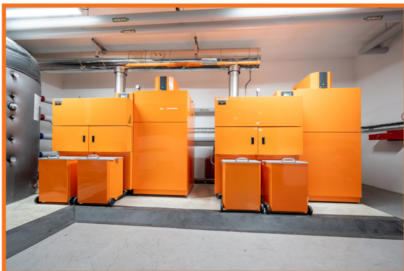
Deux chaudières GM EASY 96 montées en cascade assurent le chauffage central par aérothermes de notre atelier de 2500 m 2 à Torcy en Seine-et-Marne.
